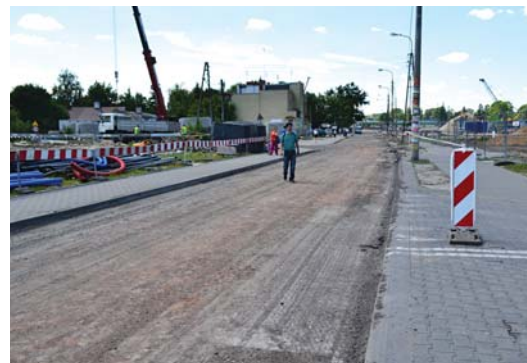
Zamknięta ul. Żegańska z zerwanym asfaltem
