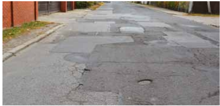
Ulica Juhasów przewidziana do odbudowy bardzo zniszczonej, jak widać, nawierzchni
