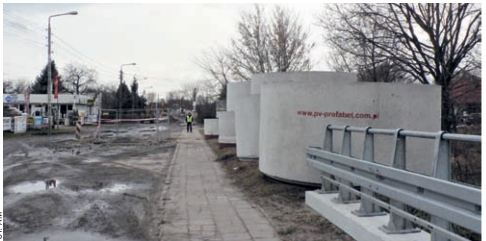
Na wkopanie na odcinku do Traktu Lubelskiego czekały na początku stycznia nowe betonowe kręgi
