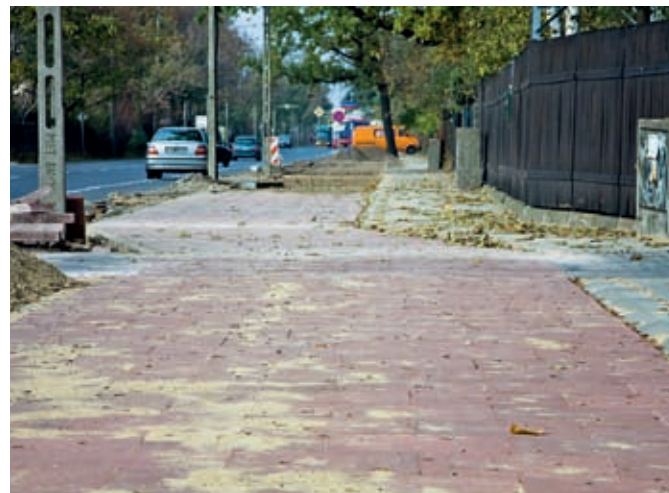
Wzdłuż ul. Wydawniczej i Szpotańskiego zbudowana została ścieżka rowerowa z prawdziwego zdarzenia oraz nowy chodnik
